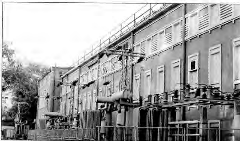
ТЕЦ-3 (СТ-1). Споруда блоку розподільчого улаштування (РУ) 10,5 кВт. Фрагмент фасаду. Фото автора 2005 р.
