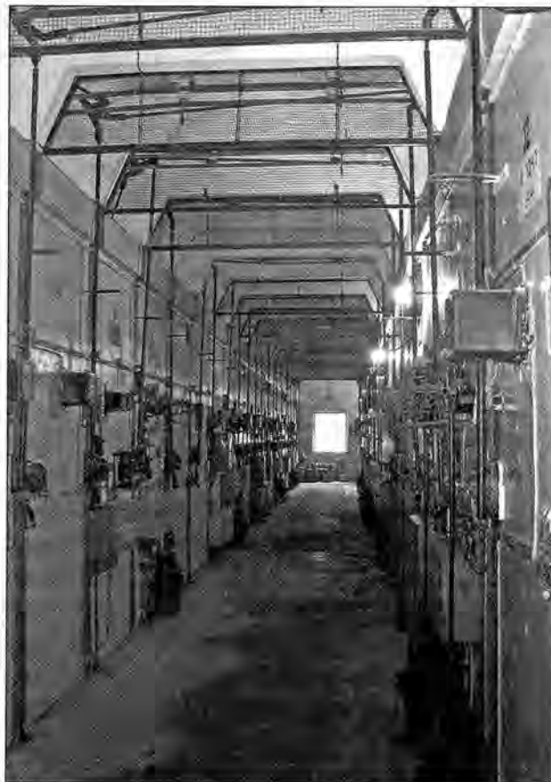
Розподільча станція Центральної електричної станції. Інтер'єр першого поверху. Фото автора 2007 р.
