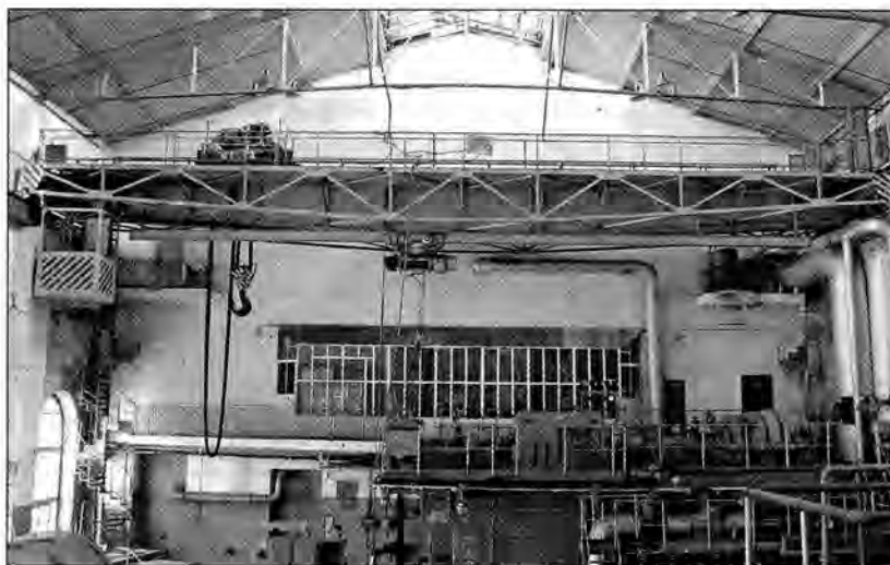
Київська Центральна електростанція, головний корпус. Інтер'єр машинної зали з мостовим краном та пунктом керування. Фото автора 2007 р.
